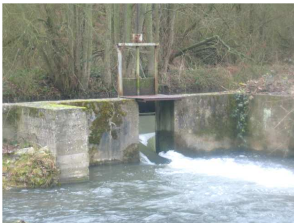
Ouvrage franchissable si vanne ouverte (L'Auget)
