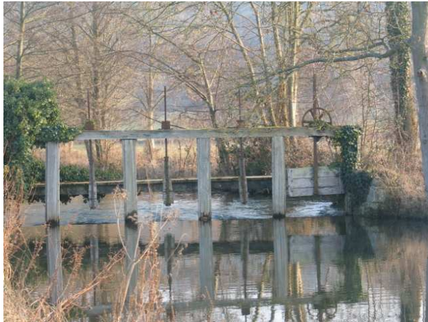
Ouvrage en mauvais état (Vannes bleues à Mesnil-sur-l'Estrée)
